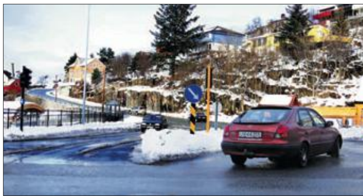
Dalegata: Hull i veibanen etter avkjøring fra riksveien.
