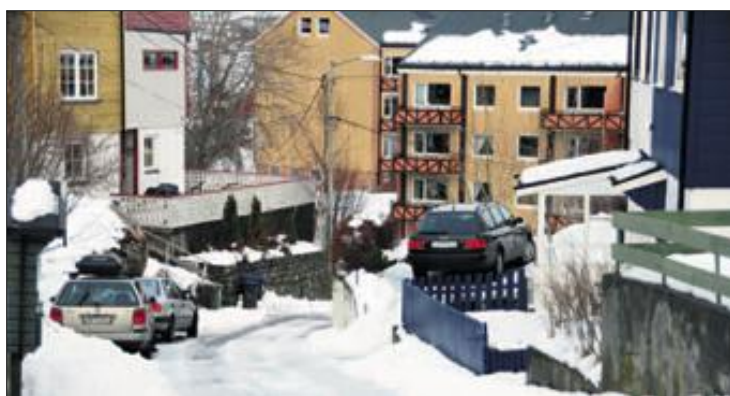
Mindebakken: Hull i veien etter graving for to år siden.
